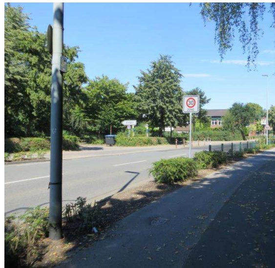
Abbildung 85: Schadhafte Wegeoberfläche auf der Kirchstraße in Hiesfeld
