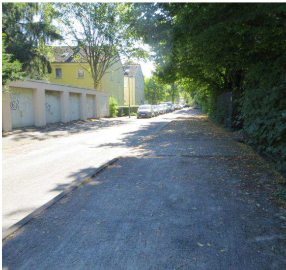
Abbildung 84: Schadhafte Wegeoberfläche auf der Kanzlerstraße in Hiesfeld
